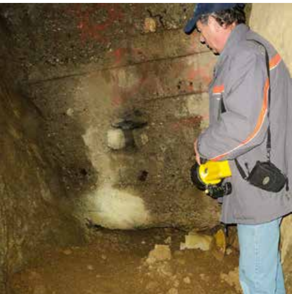
Luknja v betonski pregradi. FOTO BORIVOJ LADIŠIĆ
